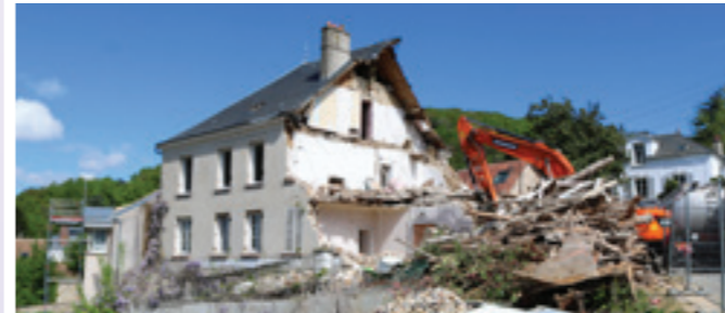
24 avril : Démarrage de la démolition du bâtiment de l'ancienne Trésorerie Voir l'article en p.8
