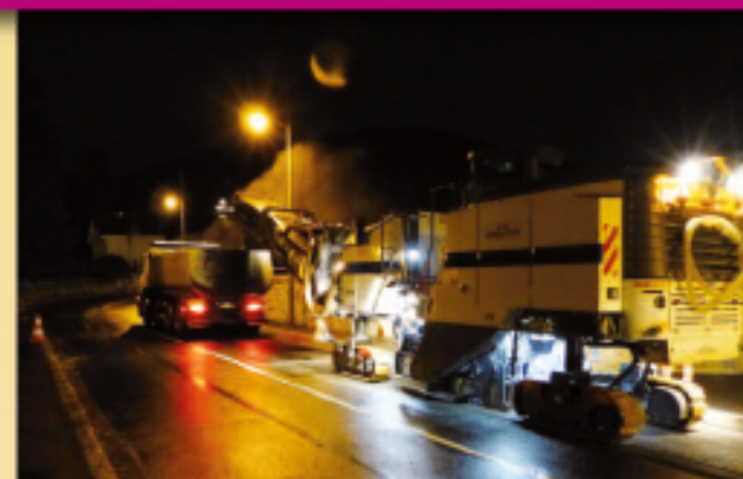
22 SEPTEMBRE • Travaux de nuit rue Pierre Chesneau, remise à neuf des enrobés.
